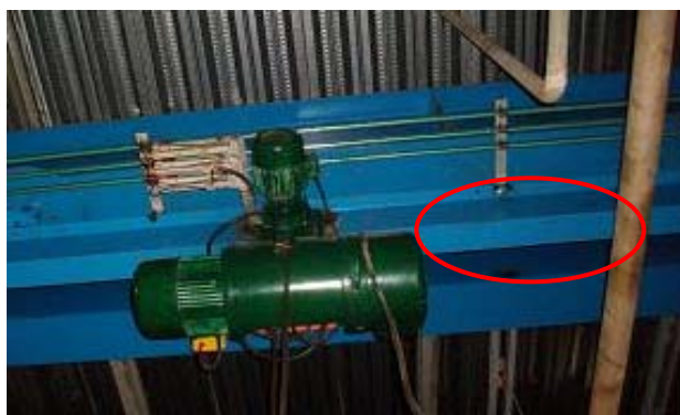
该图为电动葫芦无法穿过右侧管道
